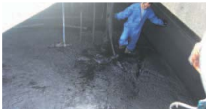
このような汚泥回収作業が、8分の1になりました。
